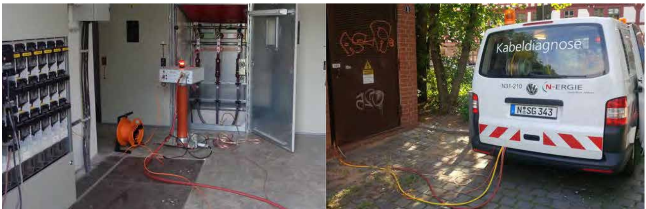
Abbildung 59: Messsystem und Kabelmesswagen während Messung an einer Mittelspannungsstation
