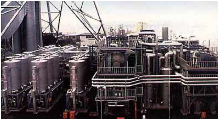
Abb. 64: Bisher größte realisiertes PAFC-basiertes Kraftwerk in der Nähe von Tokio (11 MW el ), nicht mehr in Betrieb. 122
