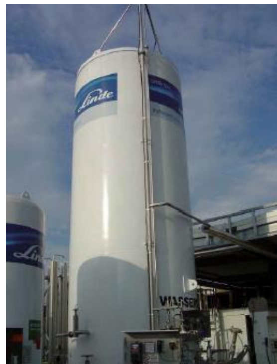
Abb. 39: Wasserstoffkryospeicher der Firma Linde
