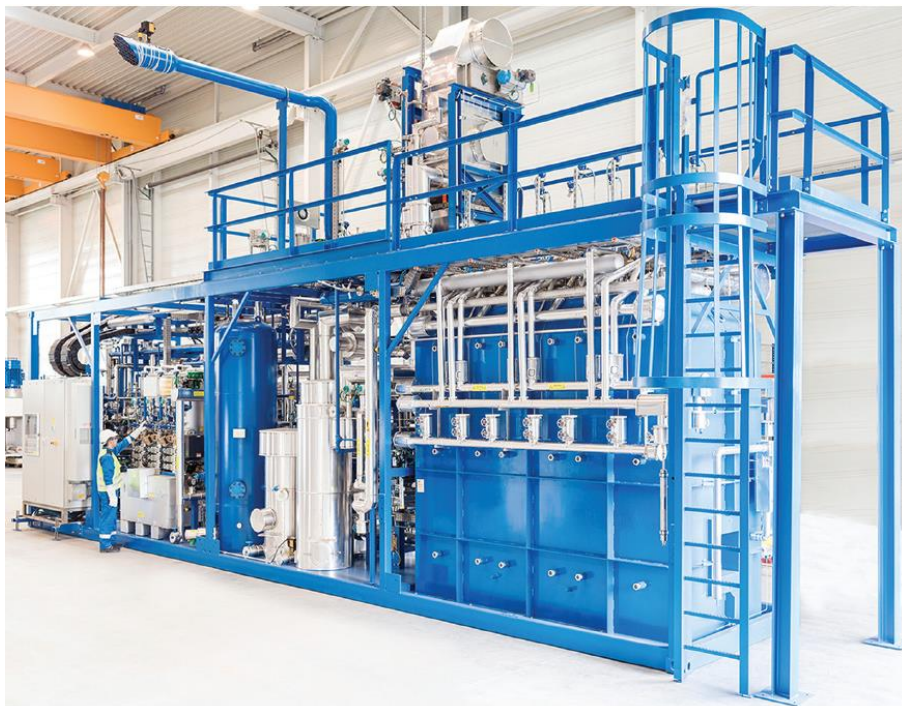
Abb. 16: HYDROPRIME-Anlage der Firma Linde bzw. Hydro-Chem zur kleinskaligen Dampfreformierung
