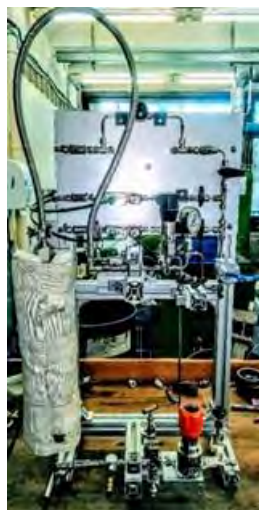
Abbildung 24: In Betrieb genommene Gasphasenanlage zur kontinuierlichen Methanolsynthese.
