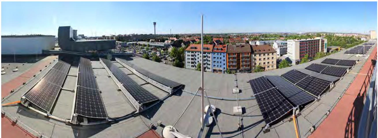
Abbildung 3: Photovoltaikanlage auf dem Dach des EnCN
