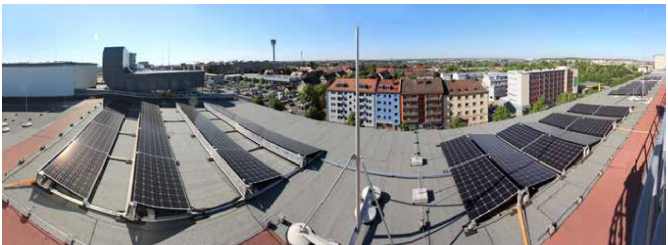
Abbildung 2: Photovoltaikanlage auf dem Dach des EnCN
