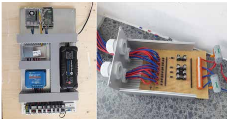
Abbildung 10: Montageplatte mit den elektronischen Komponenten des Versuchsaufbaus (links). Verschaltungsplatine mit Dioden und Sicherungen (rechts).
