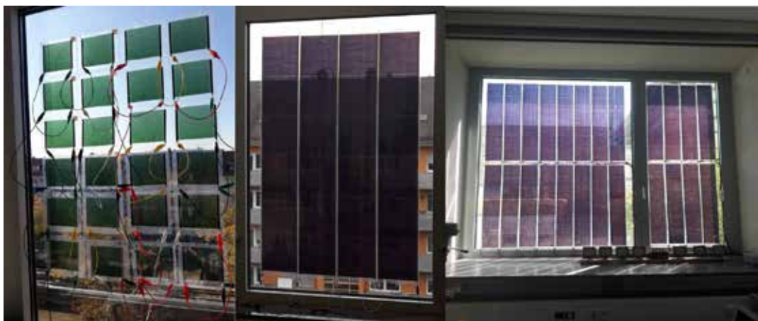
Abbildung 9: Die Fläche und Leistung der eingesetzten OPV hat sich im Laufe des Versuchs sukzessive erhöht.
