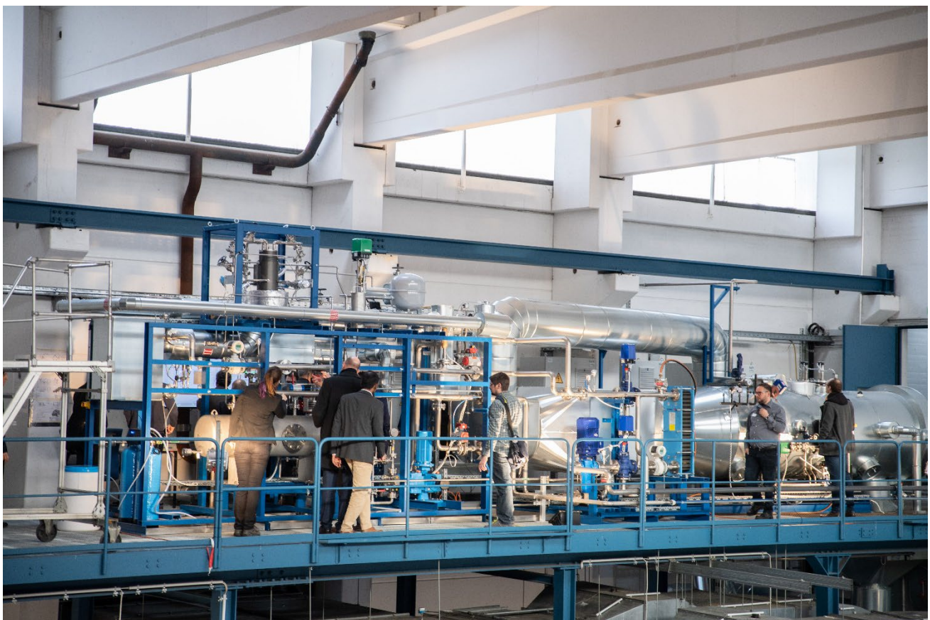
Versuchsanlage zur Abwärmeverstromung auf Basis des Clausius-Rankine-Prinzips mit Mikro-Dampfturbine
