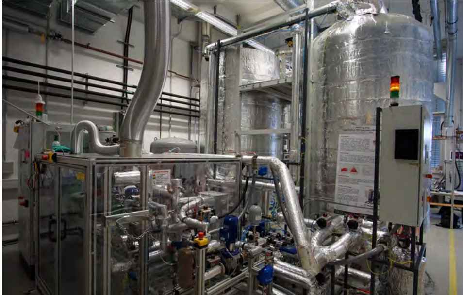
Abbildung 12: Fertiggestellte Gesamtanlage bestehen aus HP/ORC Prozess (links) aus Teilprojekt 1.2 und Heißwasserspeichersystem (rechts) aus Teilprojekt 2.1
