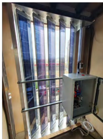
Abbildung 24: Beschattungsanlage mit beweglichen Lamellen aus glaslaminierten OPV-Modulen
