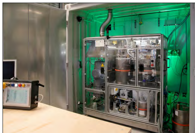
Abbildung 11: Laboranlage des LTT im Container des „Speicherhauses“ am EnCN
