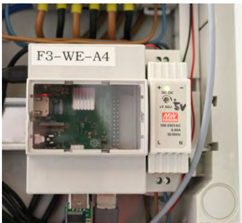
Abbildung 45: Raspberry Pi (installiert im Sicherungskasten)
