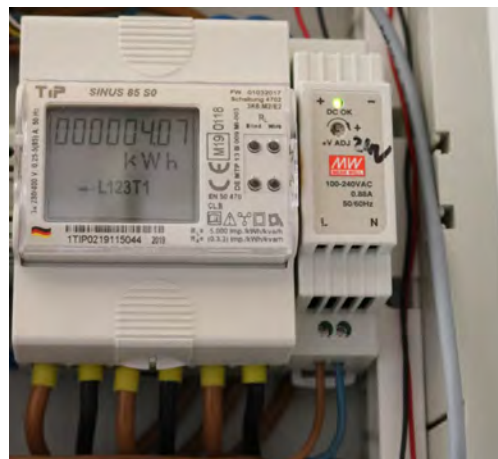
Abbildung 46: Stromzähler (installiert im Sicherungskasten)
