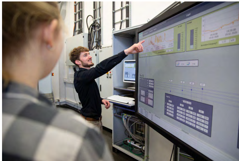
Abbildung 10: Das Mikronetz ENGiNe am EnCN wird über einen zentralen Microgrid-Controller geregelt
