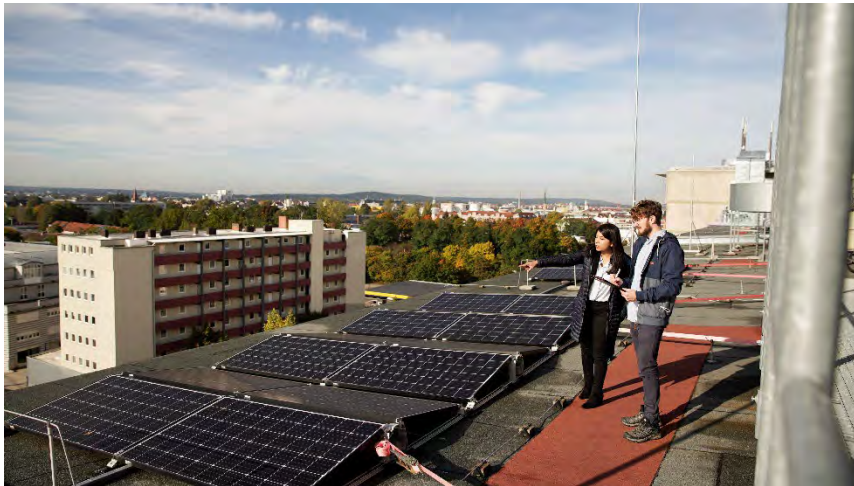
Abbildung 9: Die Photovoltaikanlage des LEES als integraler Bestandteil des Mikronetzaufbaus auf dem Dach des EnCN
