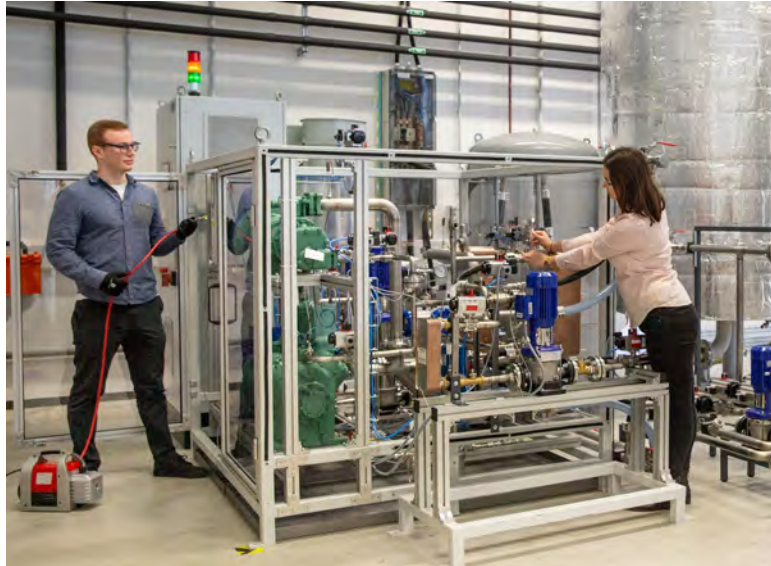
Abbildung 5: Montage der kombinierten Wärmepumpe-ORC Pilotanlage (Foto: EnCN/Zellner)
