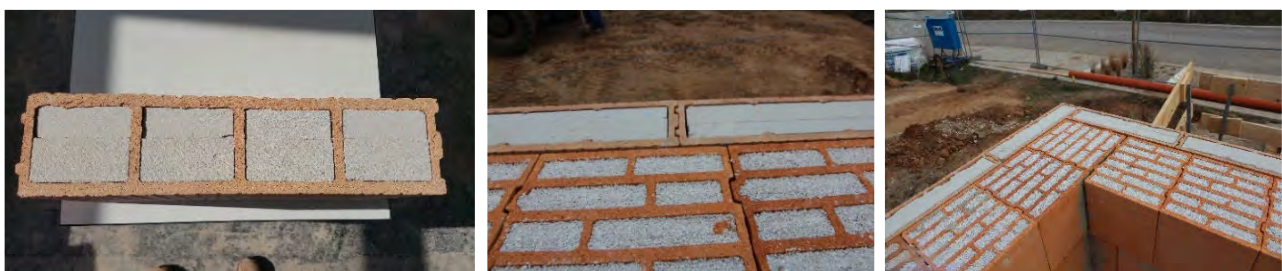
Abbildung 53: CALOSTAT-gefüllter WDF 12 Ausgleichsziegel (Links). Zweischalige Bauweise mit 30 cm dicken Perlit-gefüllten Mauerziegeln und 12 cm dicken CALOSTAT-gefüllten WDF 12 Vorsatzziegeln (Mitte). Zweischalige Bauweise im Eckbereich des Erdgeschosses (Rechts)
