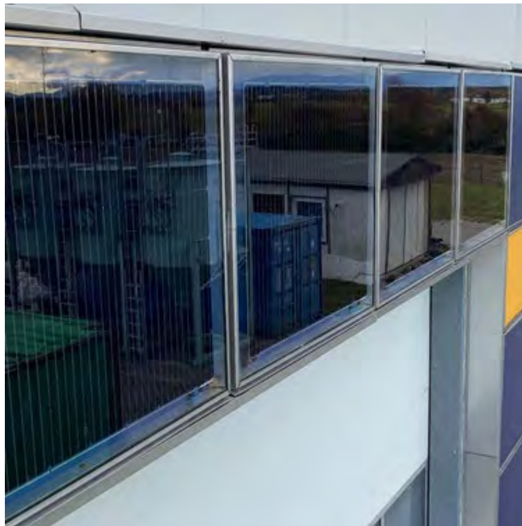
Abbildung 38: Detailansicht der am Versuchsgebäude montierten Elemente mit integrierter Photovoltaik.
