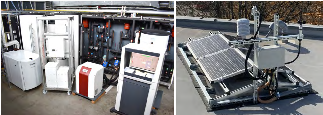
Abbildung 50: Smart Energy Bench, bestehend aus Mikro-Blockheizkraftwerk, Batteriespeicher, Sole/Wasser-Wärmepumpe und Steuerungsrechner (links) sowie Mini-PV-Anlage und Wetterstation auf dem Dach des Technikums (rechts).
