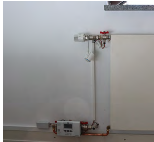
Abbildung 44: Integration Wärmemengenzähler und Heizungsstellantrieb
