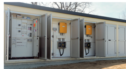
Einblick in den Quartierspeicher in Epplas, welcher nicht größer als ein herkömmlicher Ortsnetztransformator ist.
