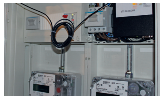
Installierte Messhardware in den Haushalten in Epplas
