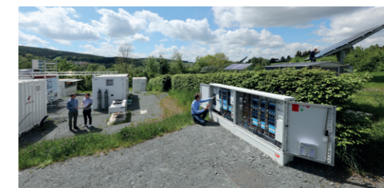
Realbetrieb zukünftiger Betriebsmittel auf einer offenen Testplattform im Arzberg
